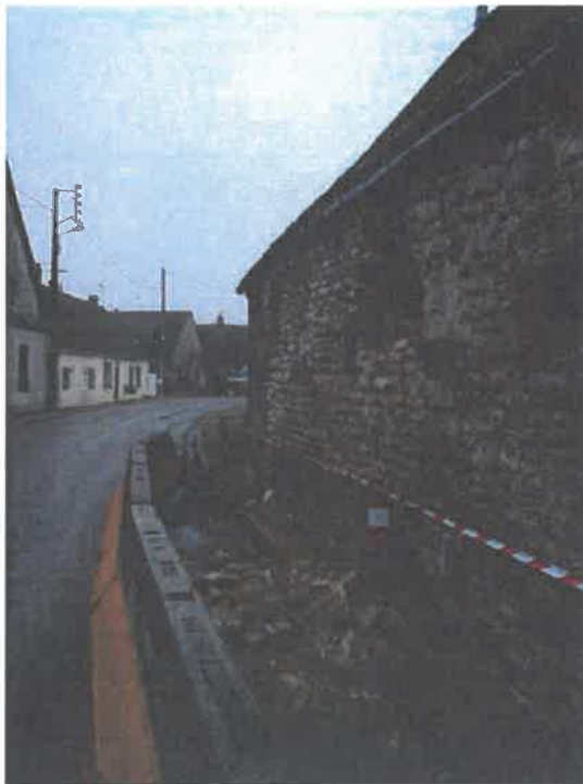
Photo 3 : Dégradations observées rue du Pavillon (RD 12 / PR 60) en 2016
